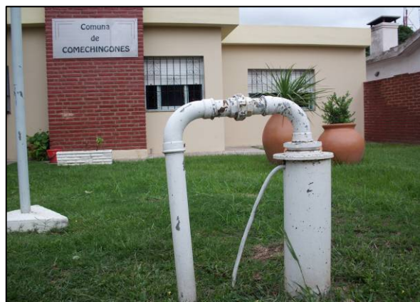
Figura 7.11 Captación de agua para consumo humano en la comuna de Comechingones
