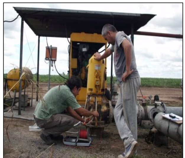
Figura 7.6 Uso de agua subterránea para riego con pivot, usando bomba cardánica de eje vertical, en perforación de 180 m encamisado en 12".
