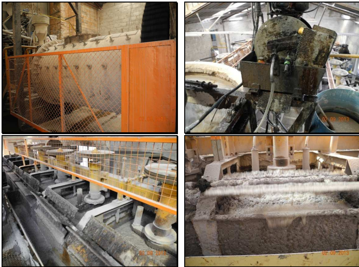
Figura 4. A) Planta de tritución de fluorita hasta los 12 mm. B) Tanques donde se le agrega soda caustica para elevar pH. C) Celdas de flotación. D) Separación de la fluorita flotada. Foto: Adolfo L. Martino
