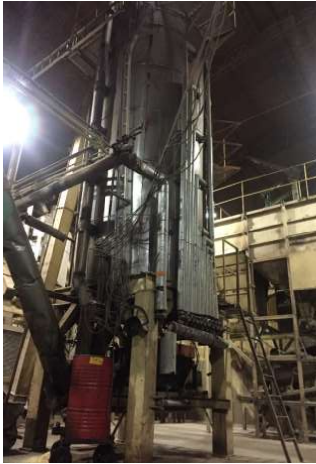
Figura AI.3: Acondicionador primario de la línea de producción 1.
