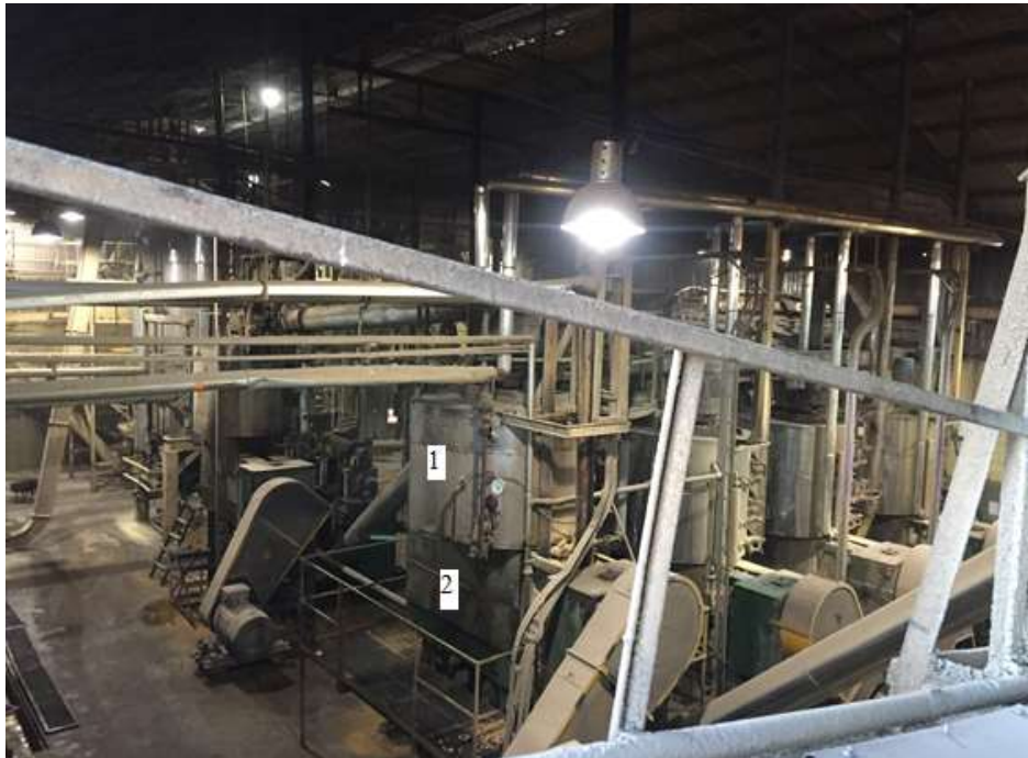
Figura AI.4: Vista parcial superior de planta. El número 1 indica el acondicionador secundario y el número 2 la segunda prensa, ambos de la línea 1 de producción.
