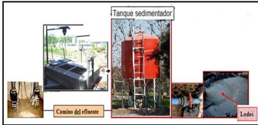
Figura 2. Efluente crudo y tanque sedimentador de lodos. Planta Piloto UNRC. Río Cuarto. Córdoba.
