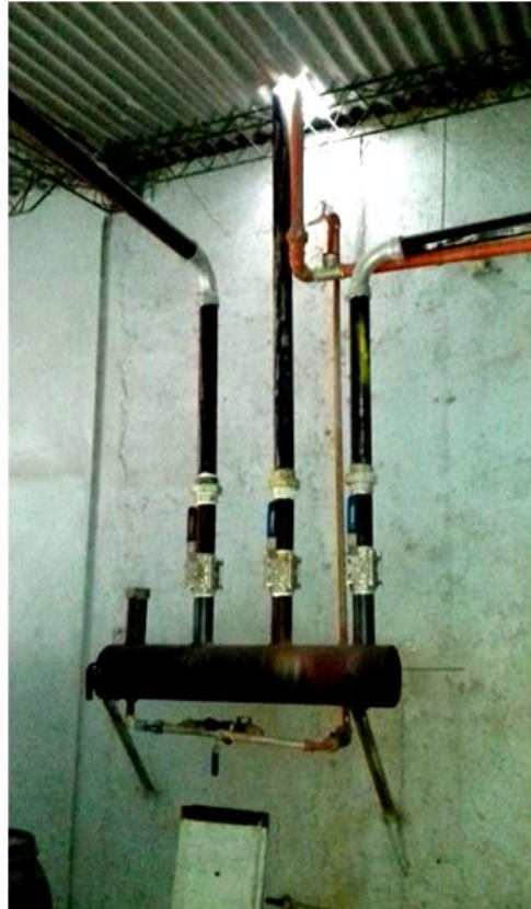
Figura AVI-14: Distribuidor de vapor
