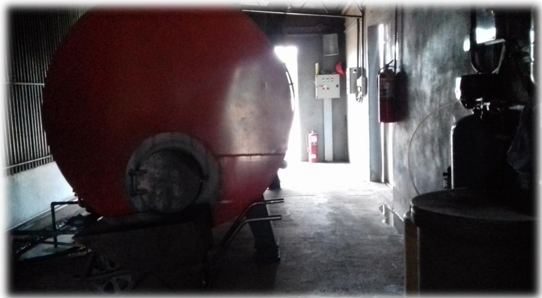
Figura AVI-10: Vista frontal de Caldera Humotubular
