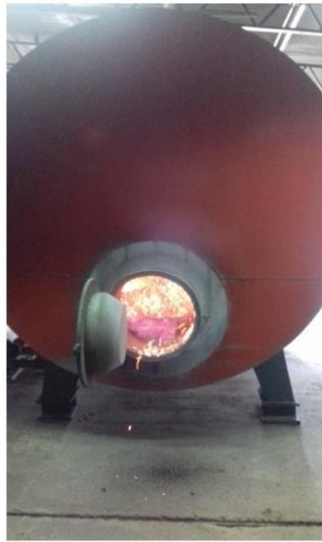
Figura AVI-12: Hogar de combustión encendido
