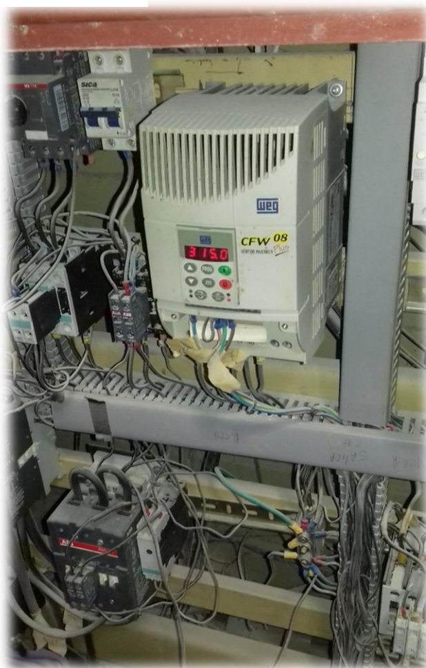
Figura AVI-5: Panel de Control-Variador [Hz]
