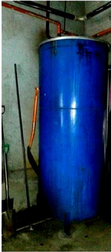
Figura AVI-13: Tanque de alimentación de agua previo a la caldera
