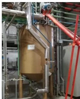
Imagen 4. Tanque de licuefacción
