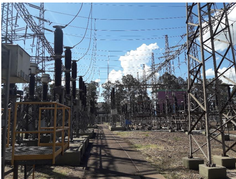
Ilustración 8: Subestación de Siderca (SE1)
