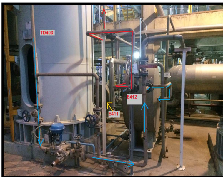
Lugar donde se encuentra el intercambiador
