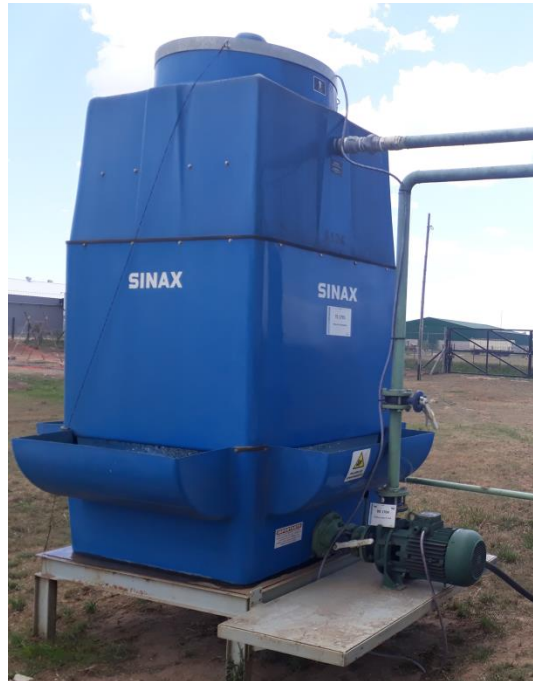
ILUSTRACIÓN A1. 6 TORRE DE ENFRIAMIENTO (TE1701)
