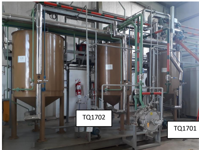
ILUSTRACIÓN A1.4 TANQUE LICUEFACTOR Y FERMENTADOR (TQ1701-TQ1702)
