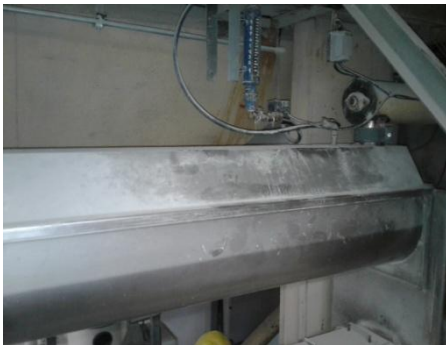
Figura 7: Humectador con medidor de caudal
