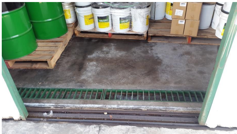
Figura 23: Desagüe Depósito de Lubricantes
