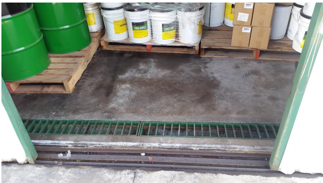
Figura 12: Desagüe Depósito de Lubricantes
