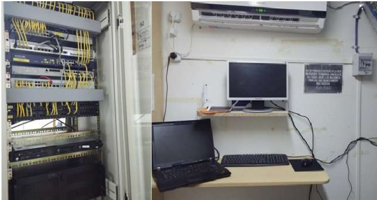
FIGURA 15 – Rack y Estación de trabajo en Sala de Servidores
