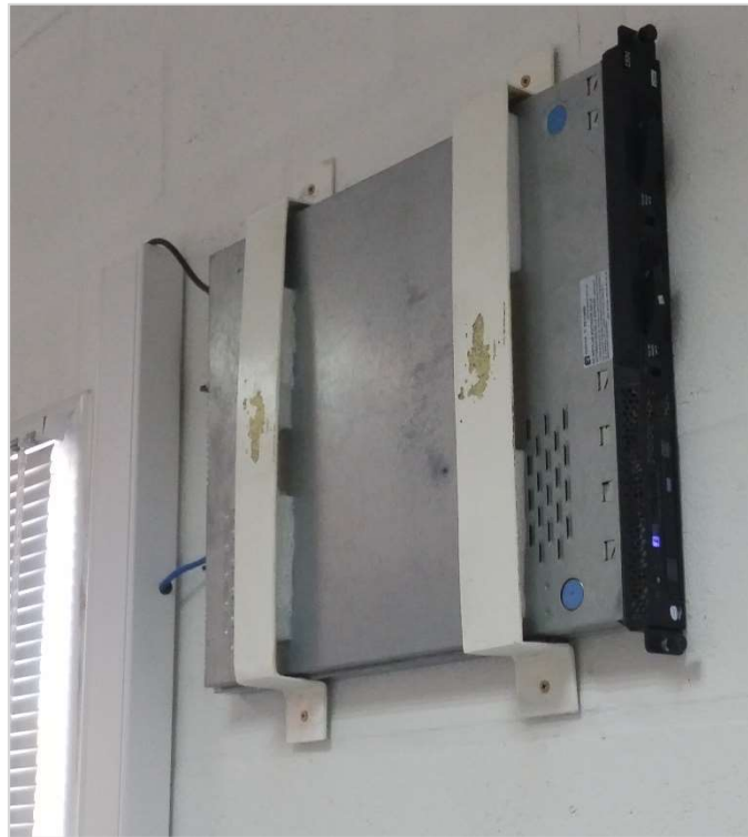
FIGURA 41–Servidor de Respaldo en funcionamiento
