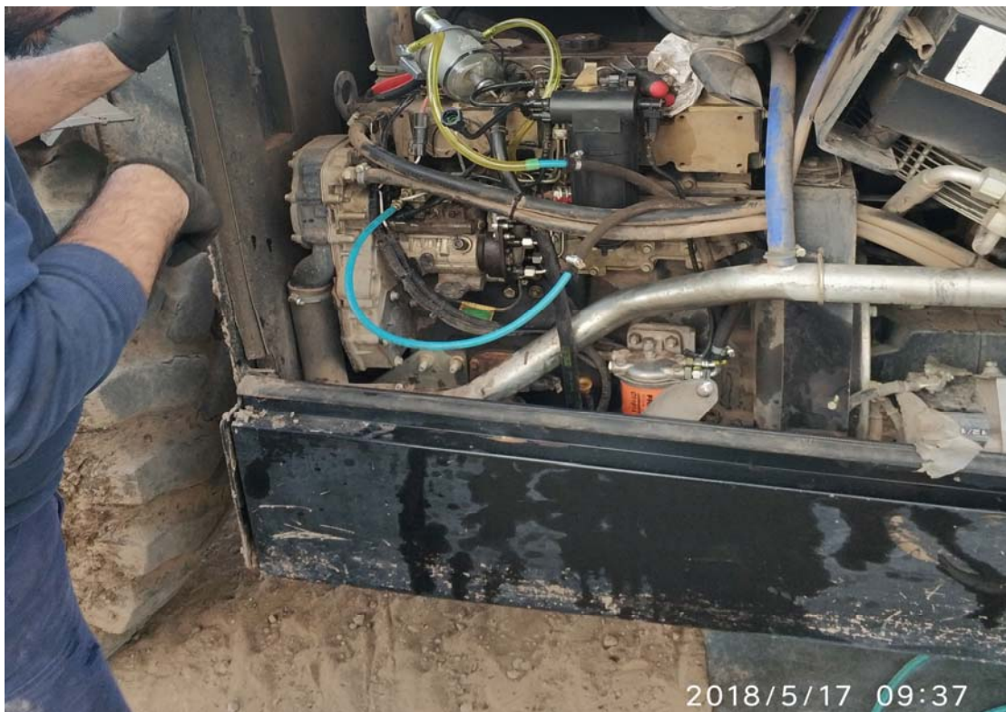
b- Instalación provisoria bomba de cebado genérica en manipulador
