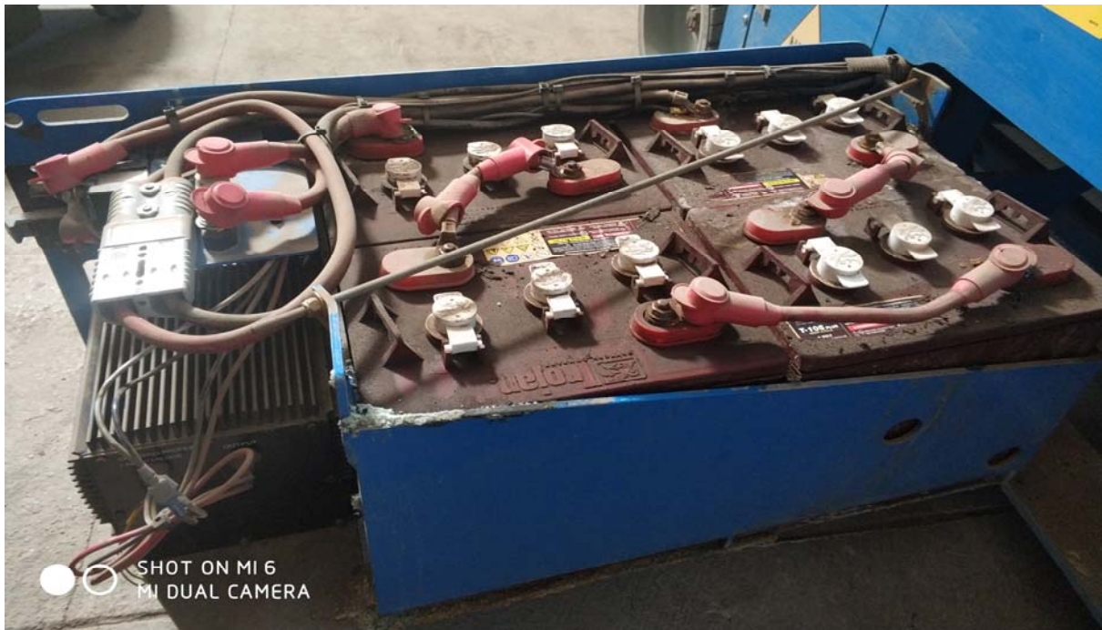
d- Cambio Pack de baterías de ciclo profundo en plataforma elevadora eléctrica
