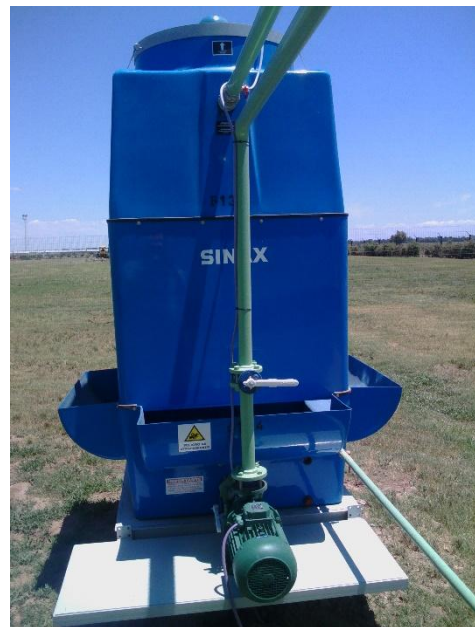
Figura A1.6 Torre de Enfriamiento TE 1701
