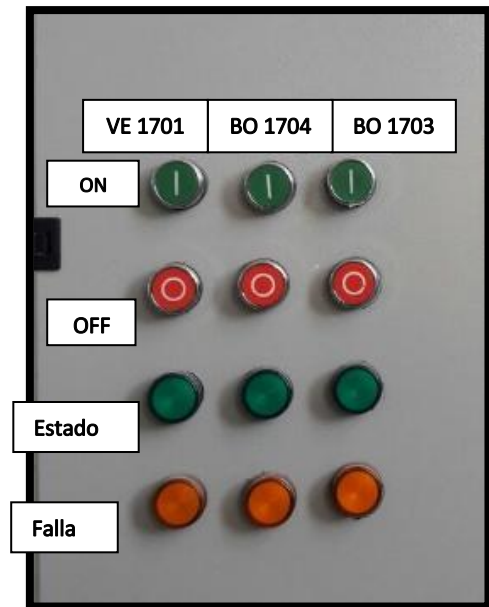
Figura A1.8 Tablero N° 2
