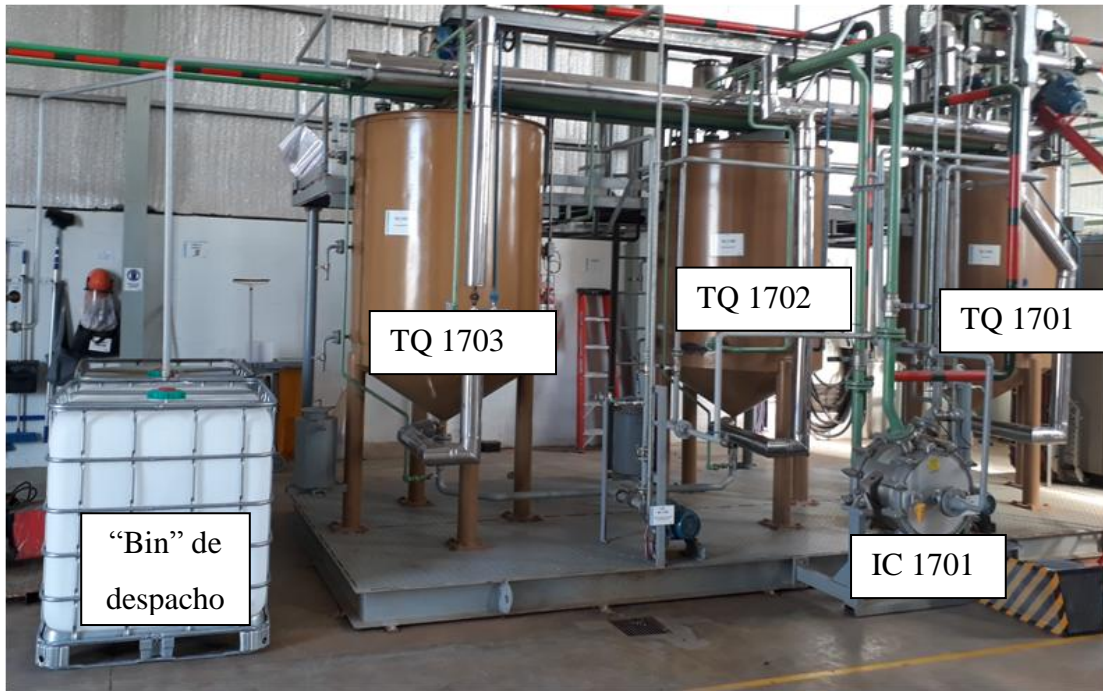
Figura A1.4 Tanques 1701/02/03; intercambiador IC 1701; Bin de despacho
