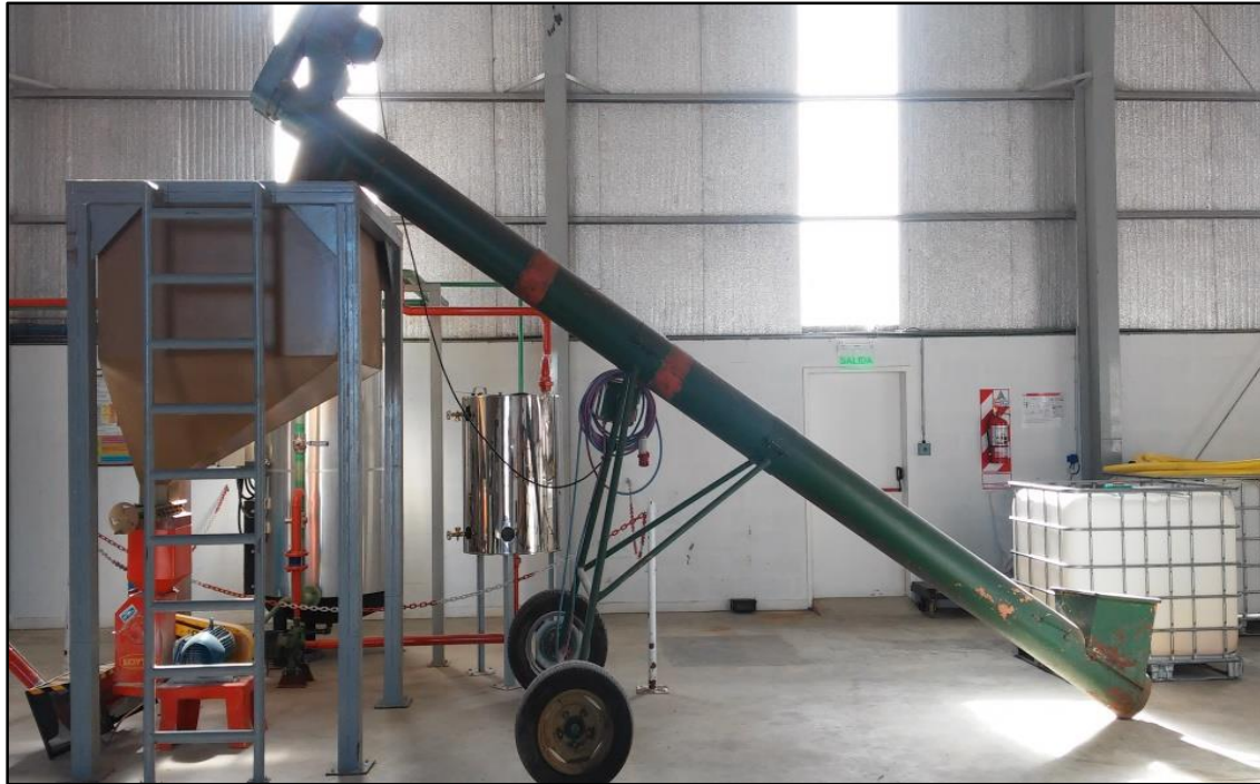
Figura A3.1: sector molienda. Chimango, tolva y molino
