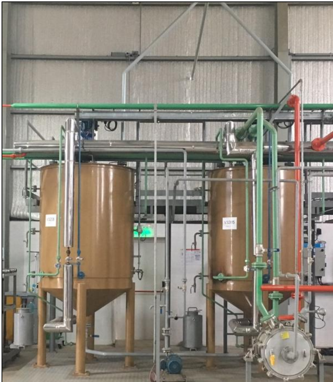
Figura A3.7: tanques de fermentación (V3205 y V3208)
