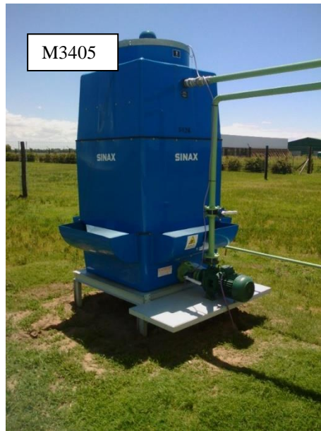
Figura AI.5 Torre de enfriamiento
