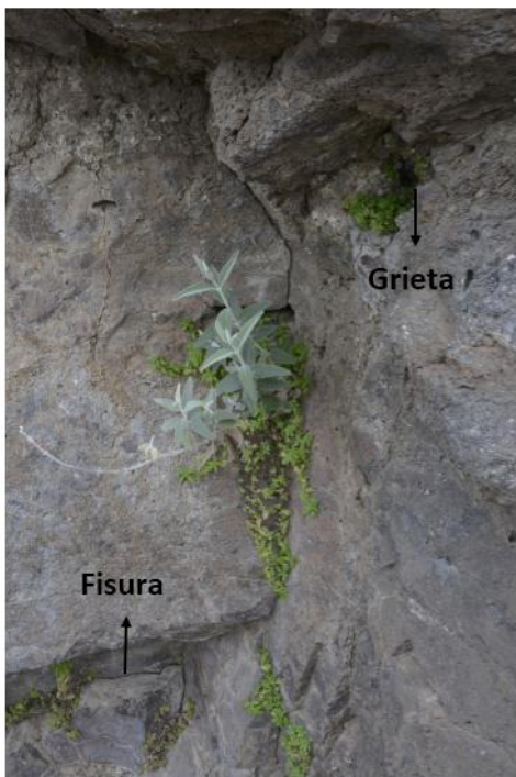
Figura 4. Grieta y fisura.
