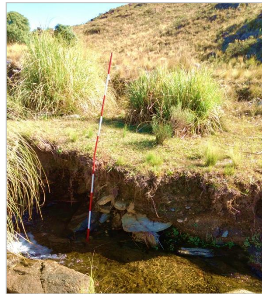
Figura VIII.42. Erosión de márgenes.
