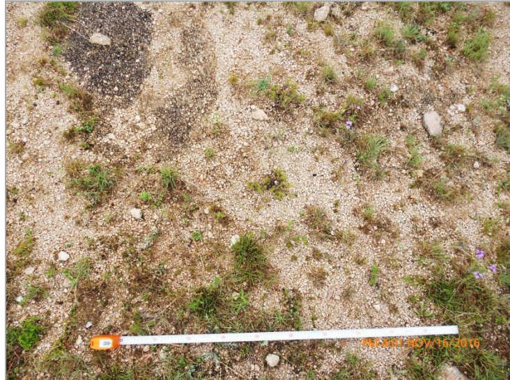
Figura IV.26. Taludes con arenización.
