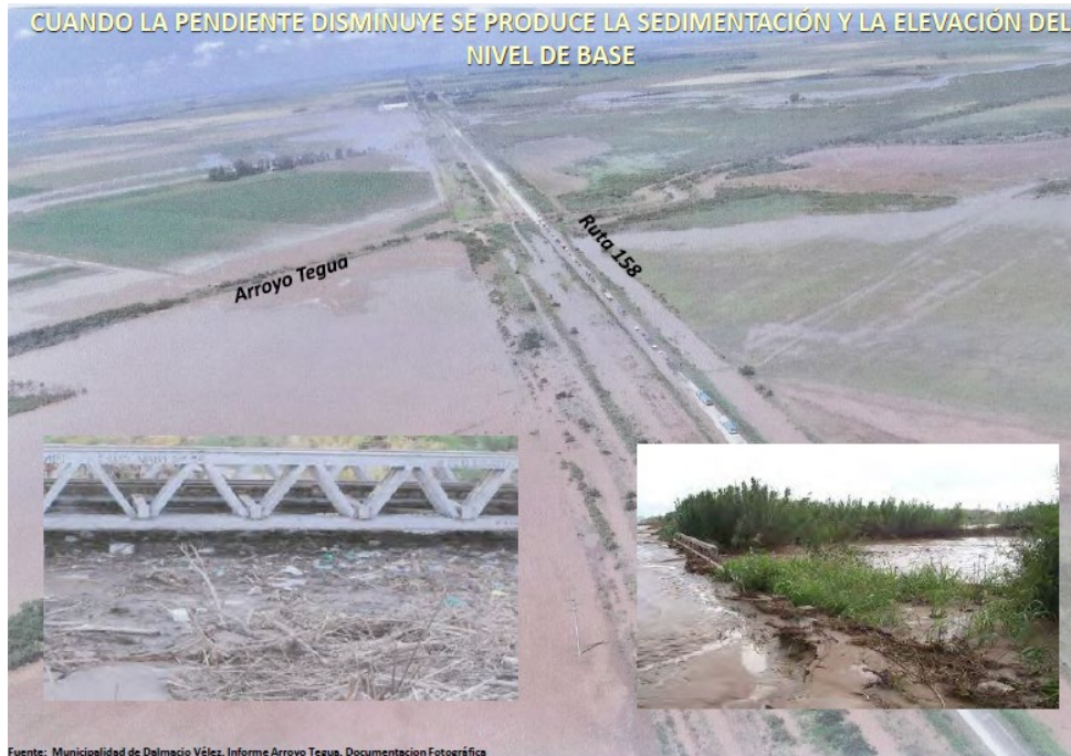
Figura 20: derrames del Arroyo tegua en las inmediaciones de la localidad Dalmacio Vélez Sarsfield. Fuente: Municipio de Dalmacio Vélez. Informe arroyo Tegua. Documentación fotográfica.
