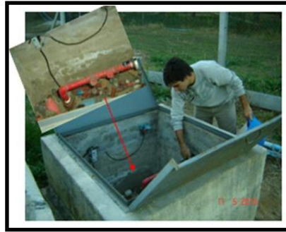
Figura 7. Equipo de bombeo y cabezal de riego. Planta Piloto UNRC.
