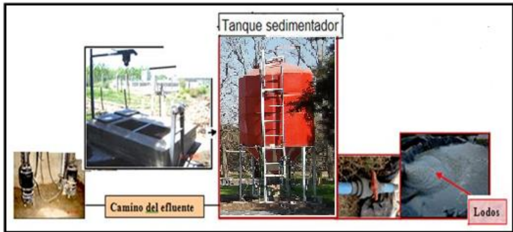
Figura 2. Efluente crudo y tanque sedimentador de lodos. Planta Piloto UNRC
