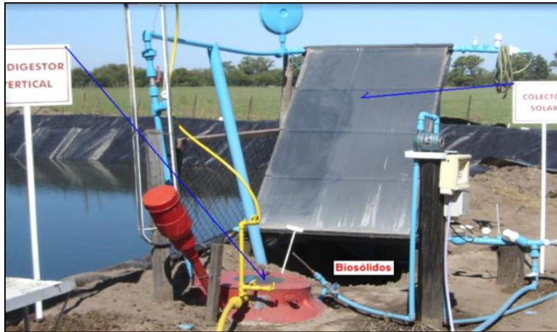
Figura 3. Proceso de biodigestión de lodos urbanos. Planta Piloto UNRC. Río Cuarto. Córdoba
