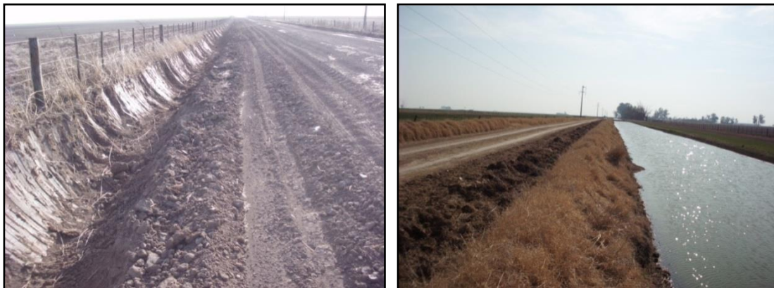
Figura 5.4. Se observan caminos alteados para evitar el corte de los mismos por anegamiento.
