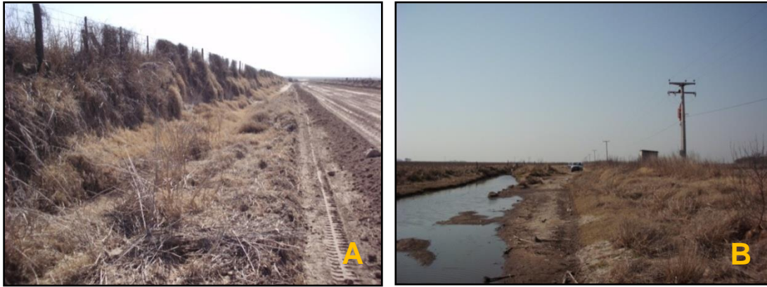
Figura 5.3. A) Camino profundizado por erosión hídrica. B) Camino cortado por anegamiento
