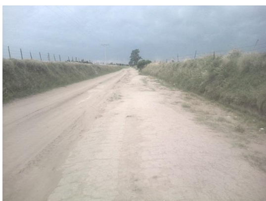
Figura 17: Camino de la cuenca funcionando como red de drenaje evidenciando procesos de erosión hídrica.
