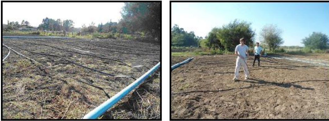
Figura 3: Línea principal de riego y cintas de goteo. UNRC. Río Cuarto. Córdoba.
