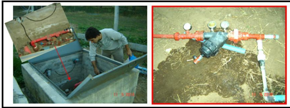
Figura 7. Equipo de bombeo y cabezal de riego. Planta Piloto UNRC. Río Cuarto. Córdoba.
