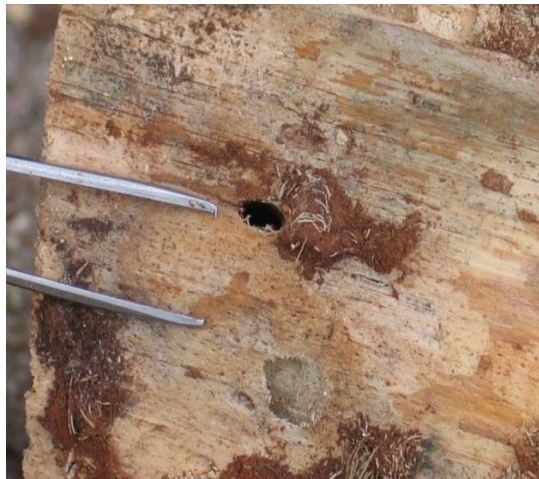
Figura 8: Trozo de madera con daños producidos por Arhopalus spp.
