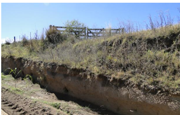
Foto N° 1: Camino de la cuenca con evidencia de procesos de erosión hídrica, funcionando como red de drenaje.
