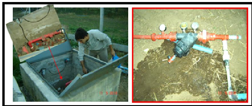
Figura 6. Equipo de bombeo y cabezal de riego. Planta Piloto UNRC. Río Cuarto. Córdoba.
