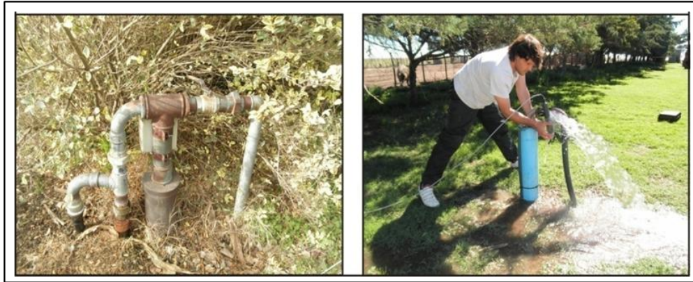
Figura 6.18: Ejemplos de perforaciones censadas con electrobomba sumergible.
