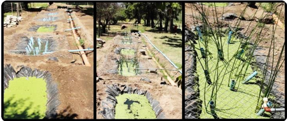
Figura 19. Sistema de humedales establecido para evaluación.
