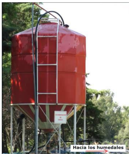
Figura 5. Tanque sedimentador de lodos. Planta Piloto de Tratamiento y Reutilización de Efluentes Urbanos de la UNRC.
