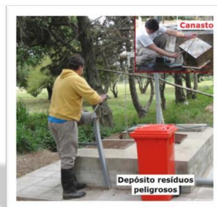
Figura 4. Canasto de prefiltrado y recipiente residuos peligrosos. Planta Piloto de Tratamiento y Reutilización de Efluentes Urbanos de la UNRC.
