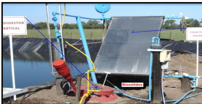
Figura 5. Proceso de biodigestión de lodos urbanos. Planta Piloto UNRC. Río Cuarto. Córdoba.
