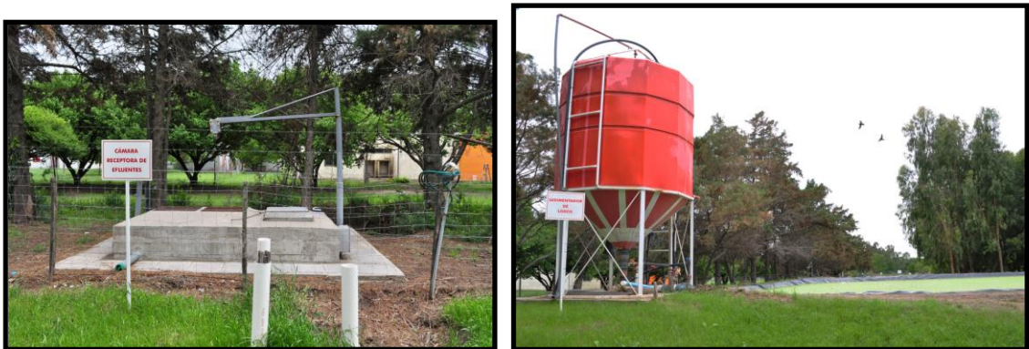
Figura 3. Cámara receptora y tanque sedimentador de lodos. Planta Piloto UNRC. Río Cuarto. Córdoba.
