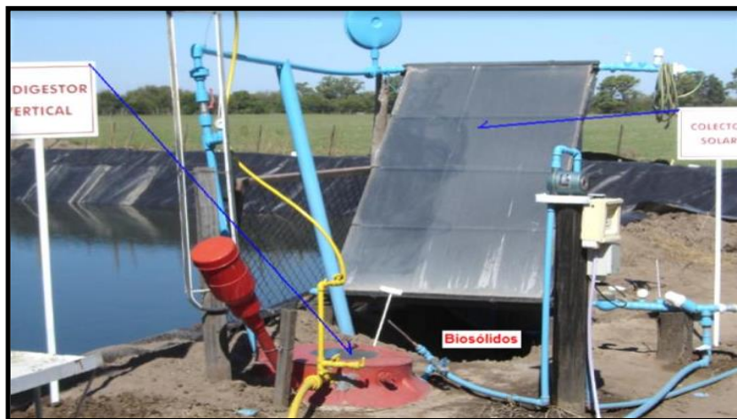
Figura 6. Proceso de biodigestión de lodos urbanos. Planta Piloto UNRC. Río Cuarto. Córdoba.
