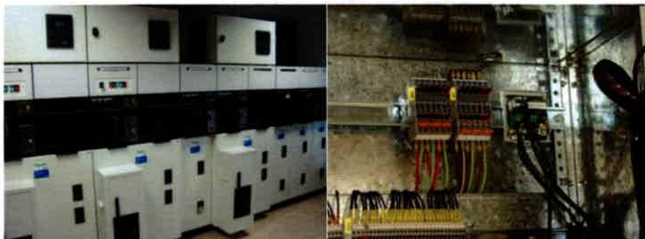
Figura V-3: Celda de Protección – Placa de comunicaciones ModBus RTU.
