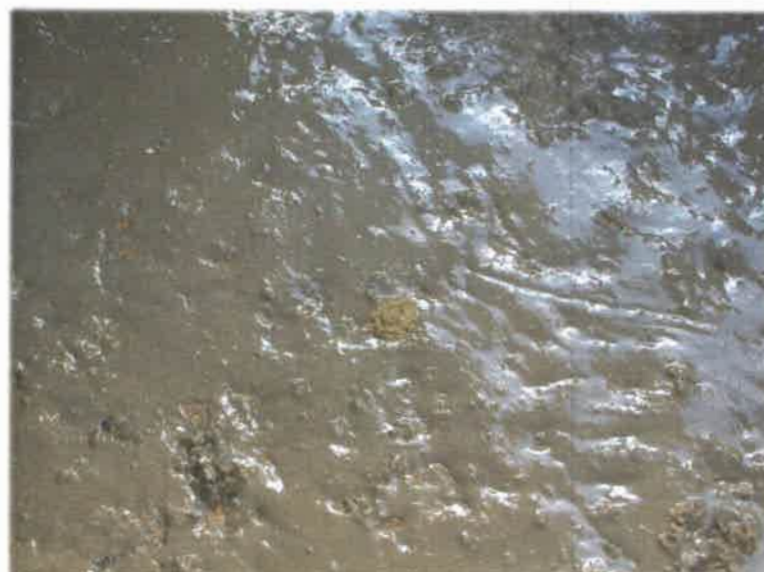
FIGURA N° 14. PISO SÓLIDO DE CEMENTO CON ACUMULACIÓN DE MATERIA FECAL
