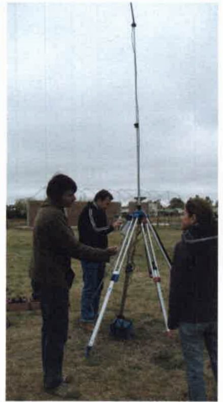
Foto 4.2. Instalación de Estación Base en FCA-UNL, Esperanza
