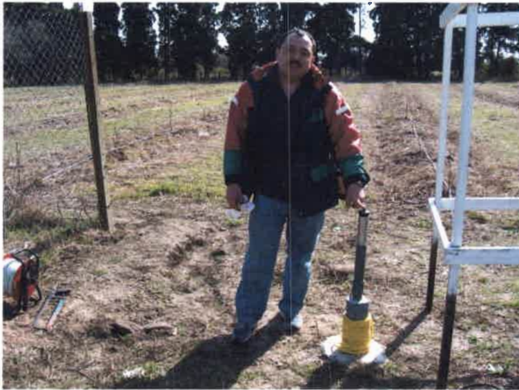
Foto 4.1. Registrador de nivel de agua subterránea por transducción de presión instalado en pozo FCA-E
