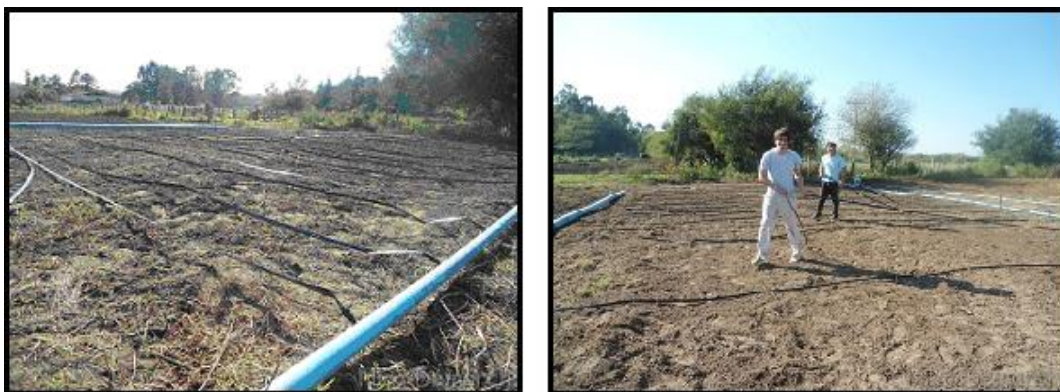
Figura 3: Líneas porta goteros y línea principal de riego. UNRC. Río Cuarto. Córdoba.
