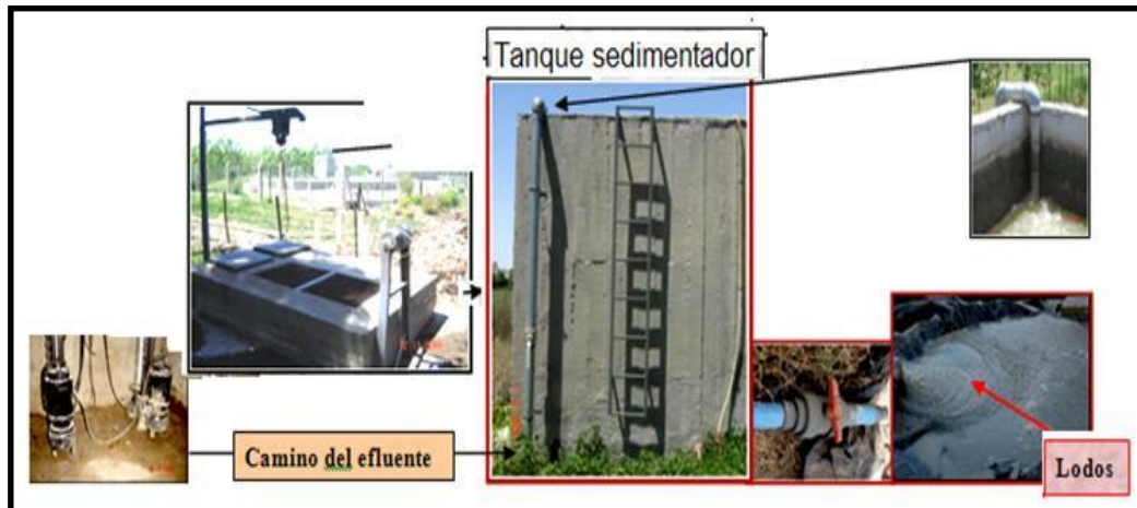
Figura 4. Efluente crudo y tanque sedimentador de lodos. Planta Piloto UNRC. Río Cuarto. Córdoba.
