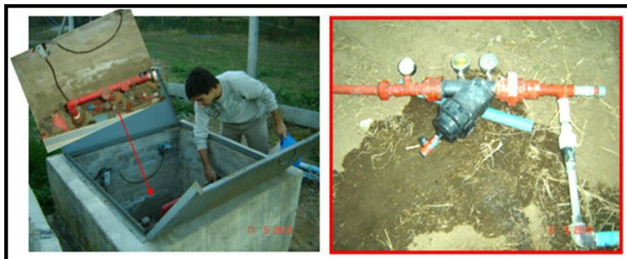
Figura 12. Equipo de bombeo y centro de control de riego. Planta Piloto UNRC. Río Cuarto. Córdoba.
