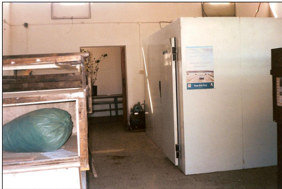
Figura 2: Cámara de frío para almacenar material vegetal.
