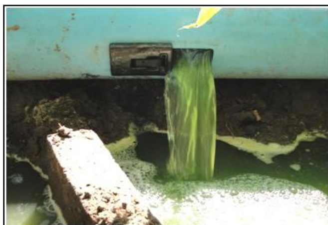
Figura 7: Tuberías con ventanitas. UNRC. Río Cuarto. Córdoba.
