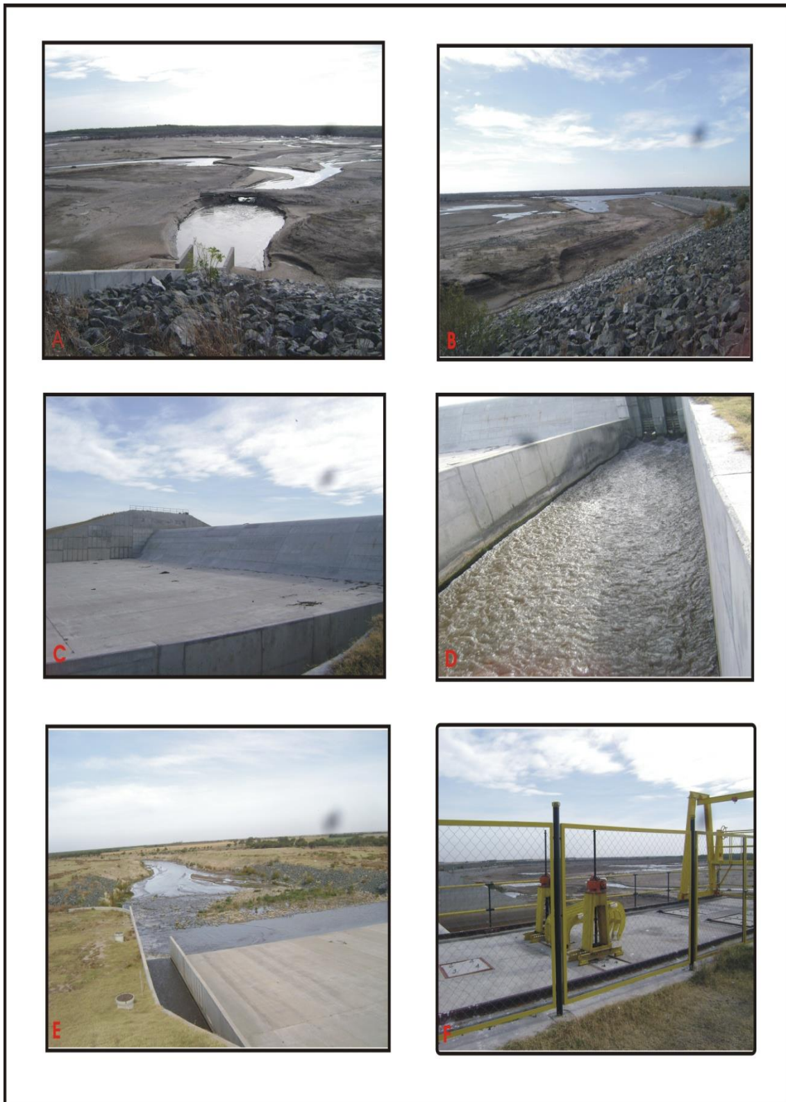
Figura 5.1b. Presa "El Chañar"(Compuertas abiertas). A-B) Vista del área donde se forma el espejo de agua. C) Vertedero por donde escurre el agua cuando la presa está llena. D) Compuertas que regulan el caudal de agua. E) Vista hacia aguas debajo de la presa. F) Mecanismos hidráulicos para maniobrar las compuertas.
