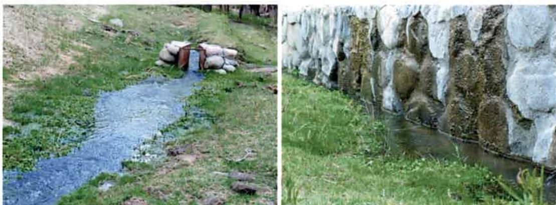
Figura 20. Filtración del Dique “Los Zazos”, Amaichá del Valle, Tucumán.
