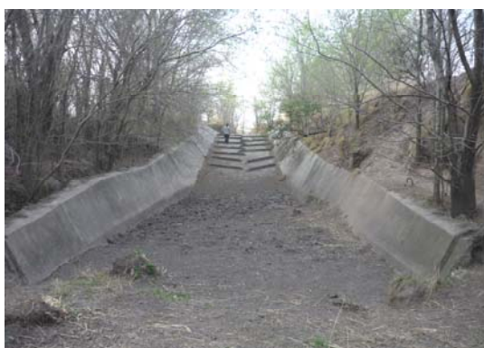
Foto V.15a.: Obra de control de cabecera en confluencia arroyos San Francisco-El Cano.
