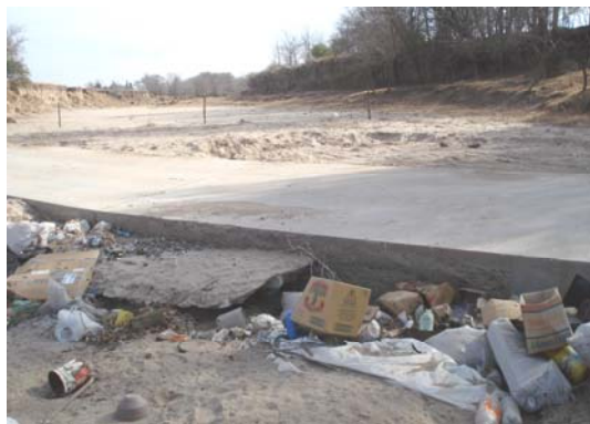
Foto VI.8.: residuos ubicados en vado de la estación de aforo (12), arroyo El Cano.
